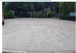
社区设施改造前
