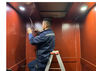
电梯内安装电动车阻车系统
